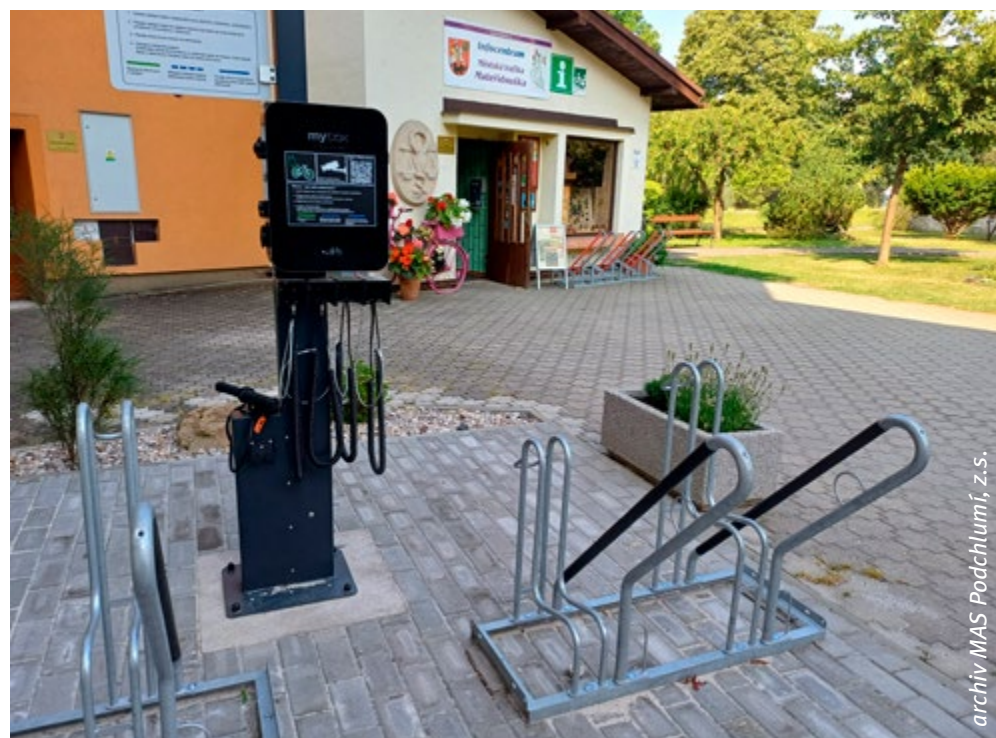
Dobíjecí stanice a stojany na kola v Miletiň
